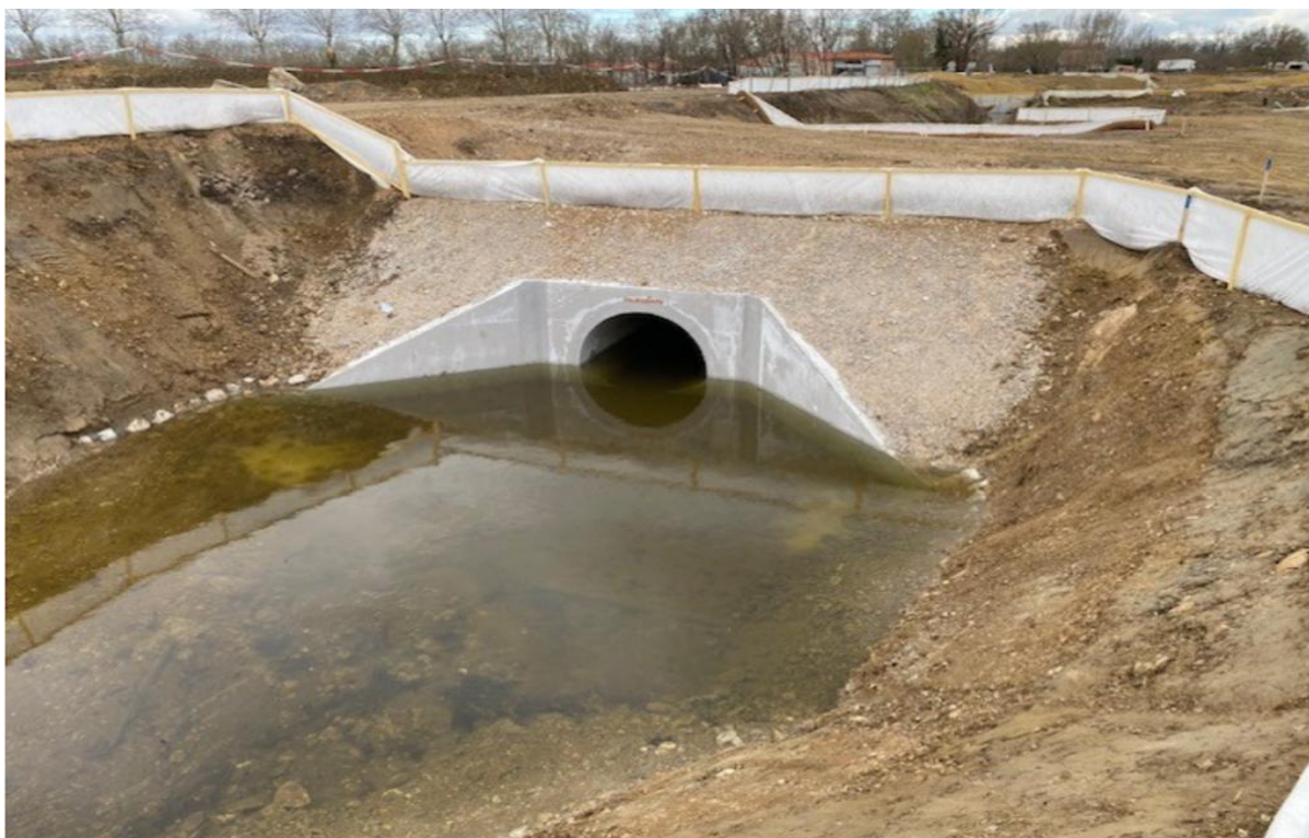
Un ouvrage potentiellement réalisé grâce à un pompage illégal dans une nappe phréatique sur le chantier de l'A69. © Direction départementale des territoires
